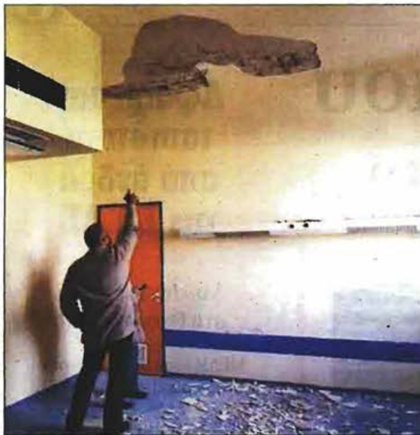
Ο θάλαμος του Γ.Ν. Νίκαιας με τον σοβά που αποκαλύφθηκε
